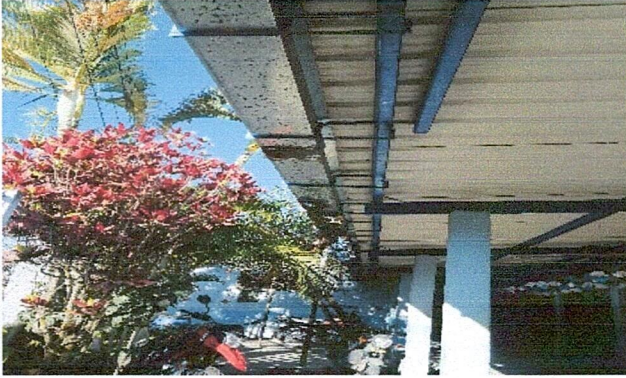
Foto 1: Canales bajadas de agua pluvial.
